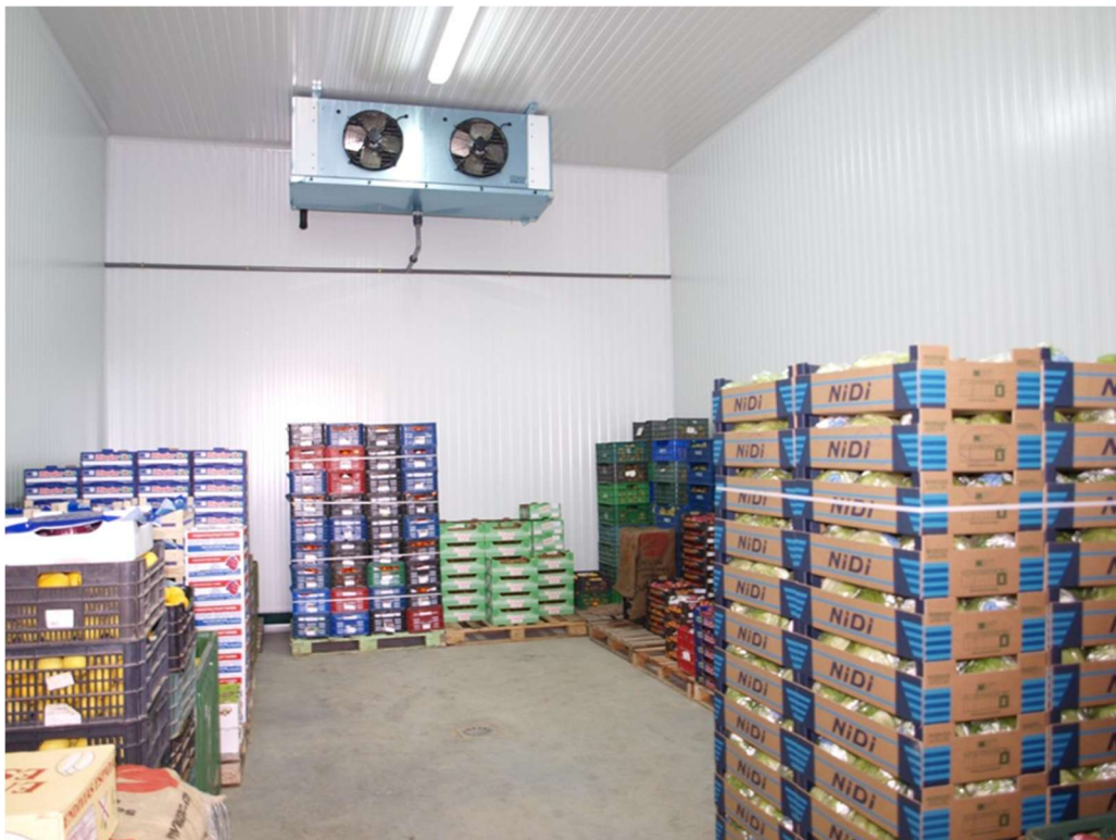
Figura 5 - Interior de câmara frigorífica
